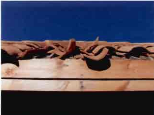
Fotografía N° 20: Detalle del estado de la cubierta de las garitas del recinto.
